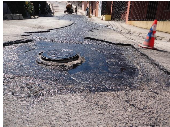
Imagen 4 Deficiencias en la colocación de emulsión
